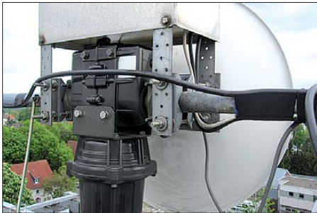
Bild 5: Damit die Koaxialleitung zum Strahler möglichst kurz ausfällt, befindet sich der Transverter direkt hinter dem Parabolspiegel unter einem Wetterschutzgehäuse.
