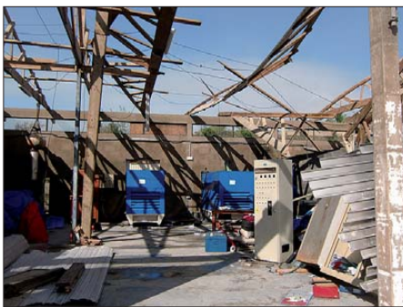
Die schwer beschädigte Generatorenstation nach dem Wüten des Zyklons „Oli“
